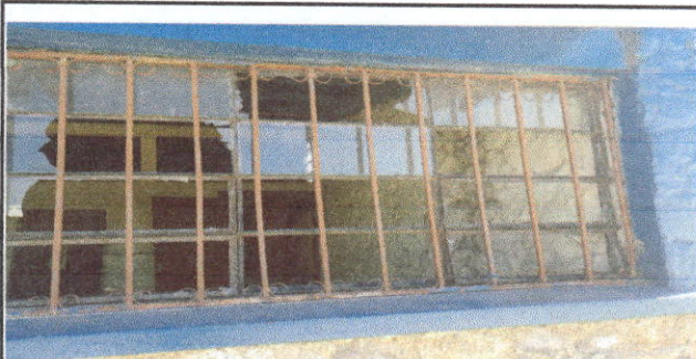
Foto 4: Se cambiará el ventanal, bancón y vidrios
